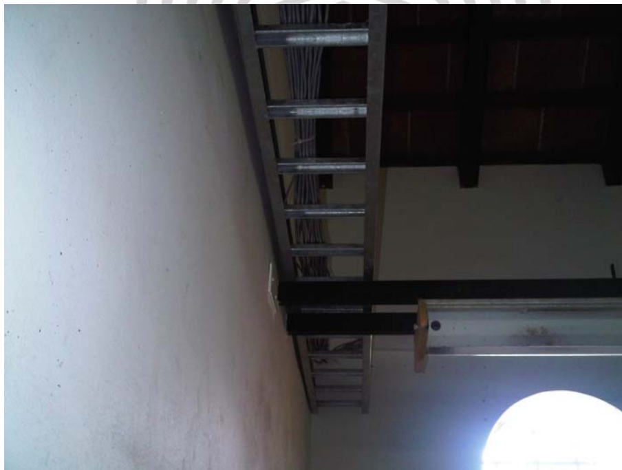
Figura 6 Bandeja, cuarto de red acondicionado en la Casa Colonial
