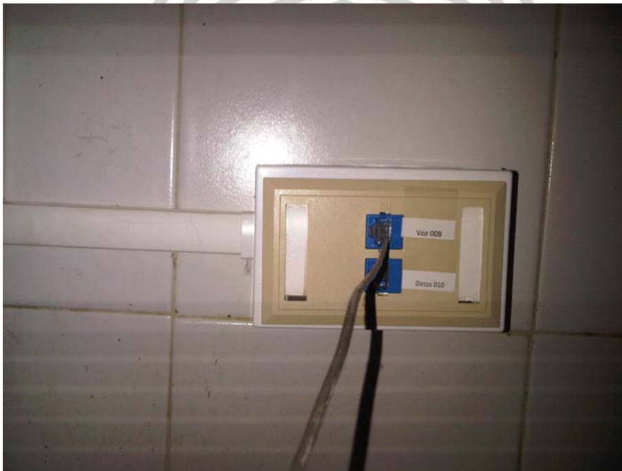
Figura 8 Tapas (Face Plate) y conectores para voz y datos instalados en la Casa Colonial
