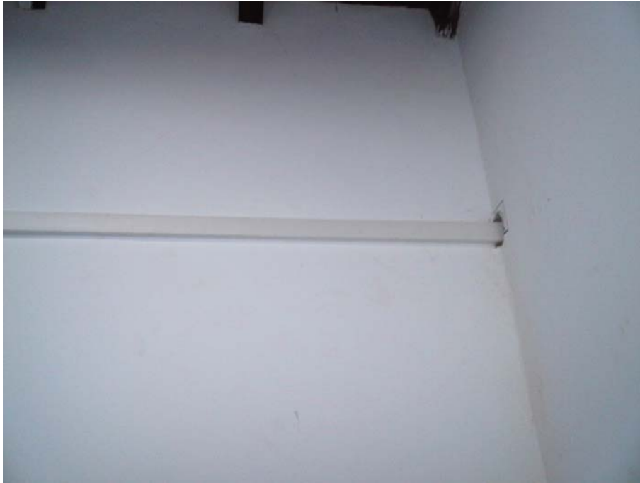
Figura 7 Canaletas instaladas en la Casa Colonial
