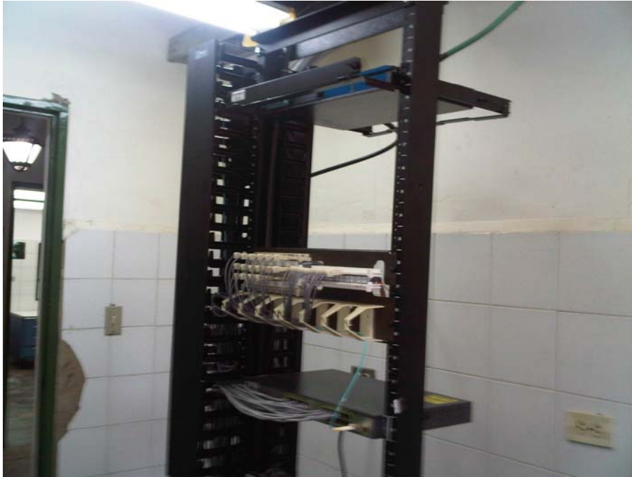
Figura 11 Rack y paneles, cuarto de red acondicionado en la Casa Colonial
