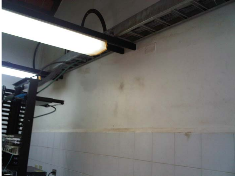
Figura 9 Rack y bandeja, cuarto de red acondicionado en la Casa Colonial
