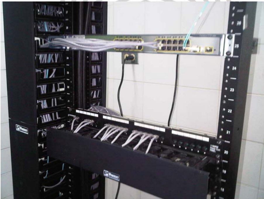
Figura 10 Rack y paneles de red, cuarto de red acondicionado en la Casa Colonial
